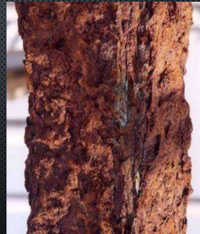
Koroze hlavního nosníku sousoší Nejsvětější Trojice v Olomouci
