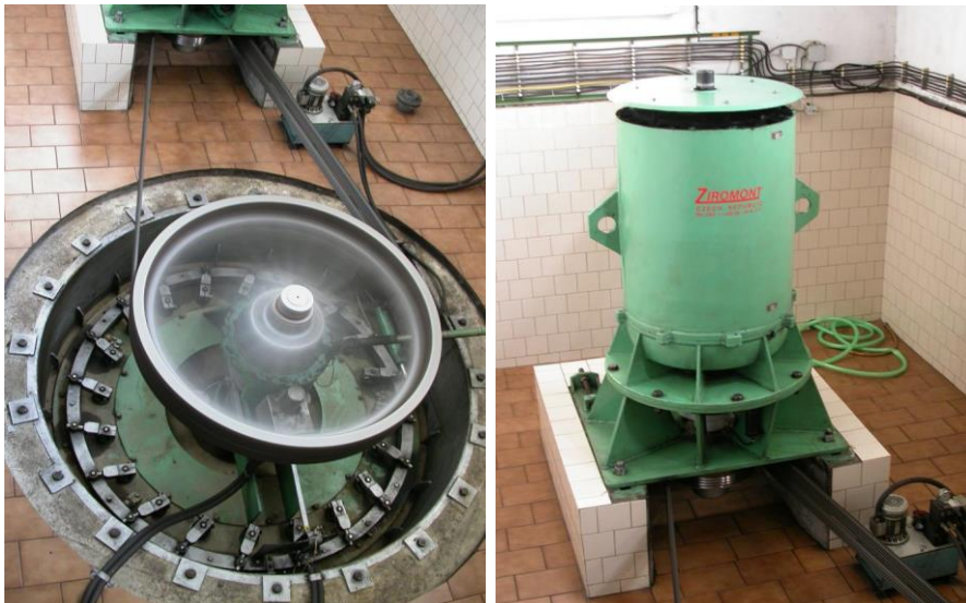
Obr. 18 Horní část turbíny s řemenovým kolem a generátor nové vodní elektrárny 120 kW
