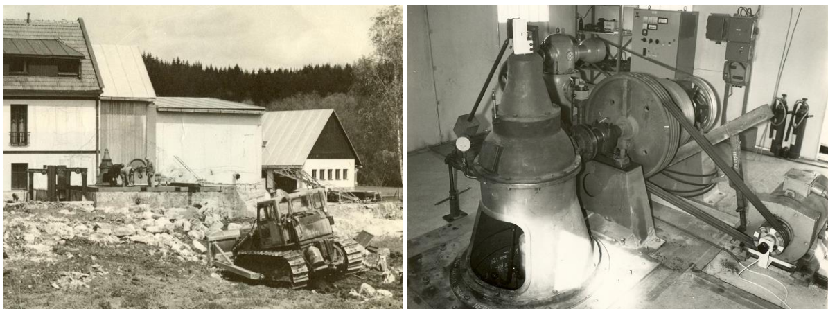
Obr. 15 Vodní turbína v průběhu úprav náhonu a poté již v plechovém objektu strojovny
