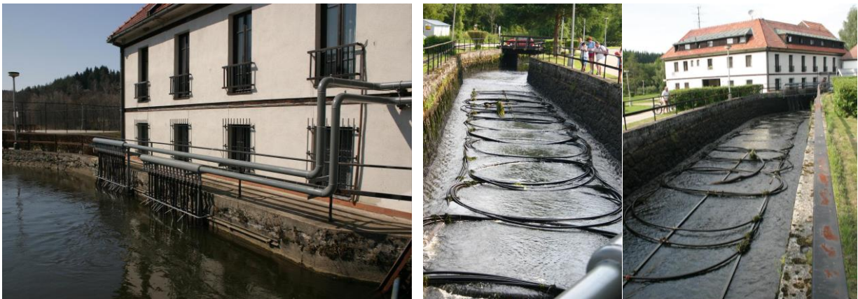
Obr. 27 Nový tepelný výměník primárního okruhu TČ umístěný na dno náhonu
