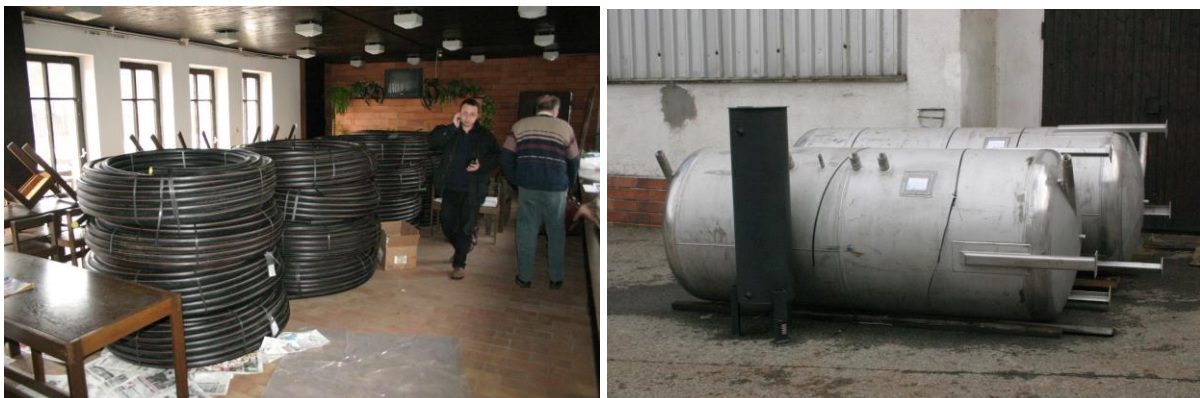
Obr. 24 Materiál připravený pro montáž (potrubí pro primární okruh tepelných čerpadel, nové nerezové akumulační nádoby pro přípravu teplé vody)
